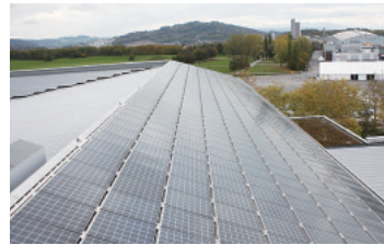
電力を供給するスタジアム屋根上のソーラーパネル(ベルン)
